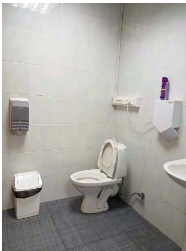
Фото 31. Состояние помещений санузла
